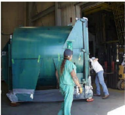
20t のリンドバーグ溶鉱炉は、ロッキーフラッツの廃炉作業の一部として建物 865 から除去されました。
